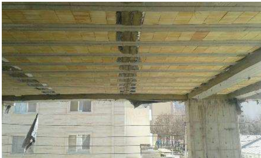
سقف اجرا شده با بلوک سقفی عایق دار جدید آماده پوشش برای پلاستر
